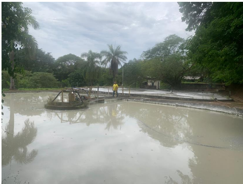
FOTO 06 - INSTALAÇÕES DE TRATAMENTO DE EFLUENTES
