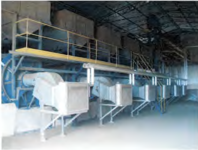
Vista interna do galpão de secador
