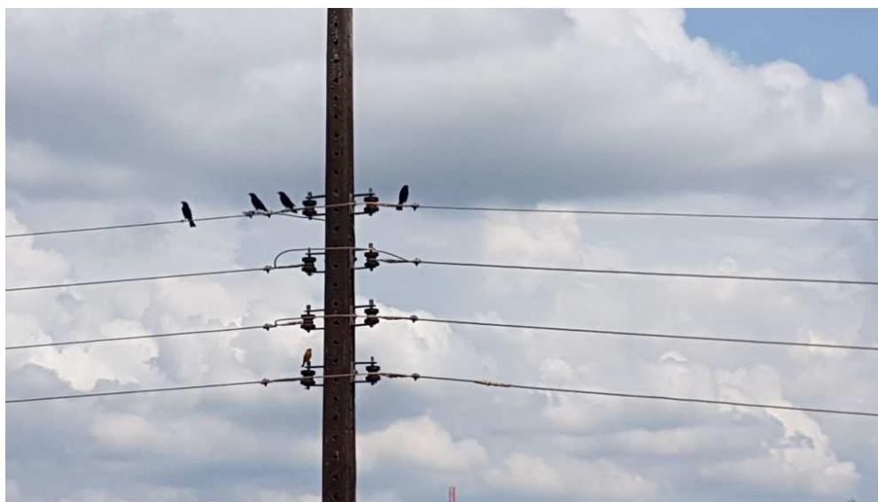
Rede de energia elétrica inserida na gleba
